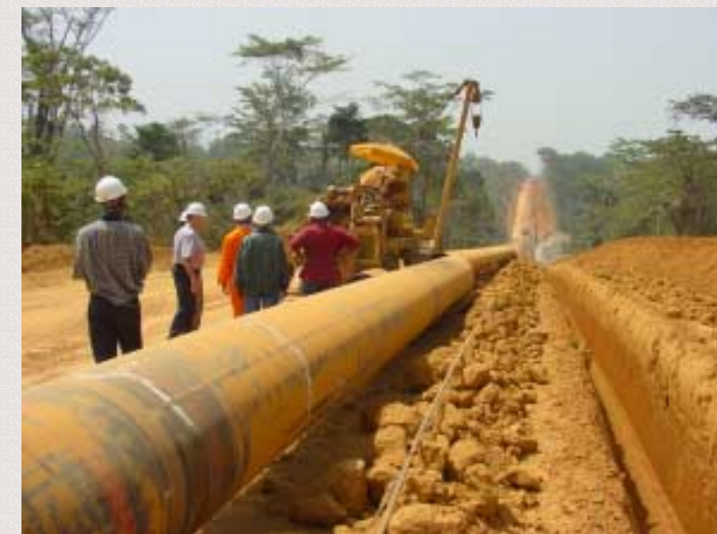
Tuyaux alignés le long de l'emprise foncière, prêts à être soudés et enfouis dans la tranchée
