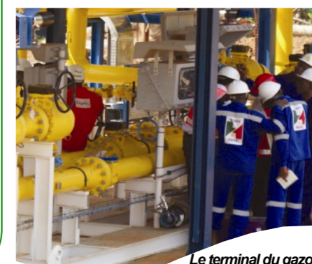
Le terminal du gazoduc à la centrale thermique
