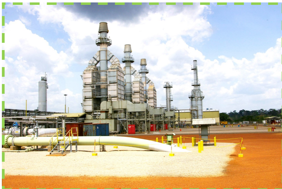
Une vue de la Station de pompage de Bélabo
