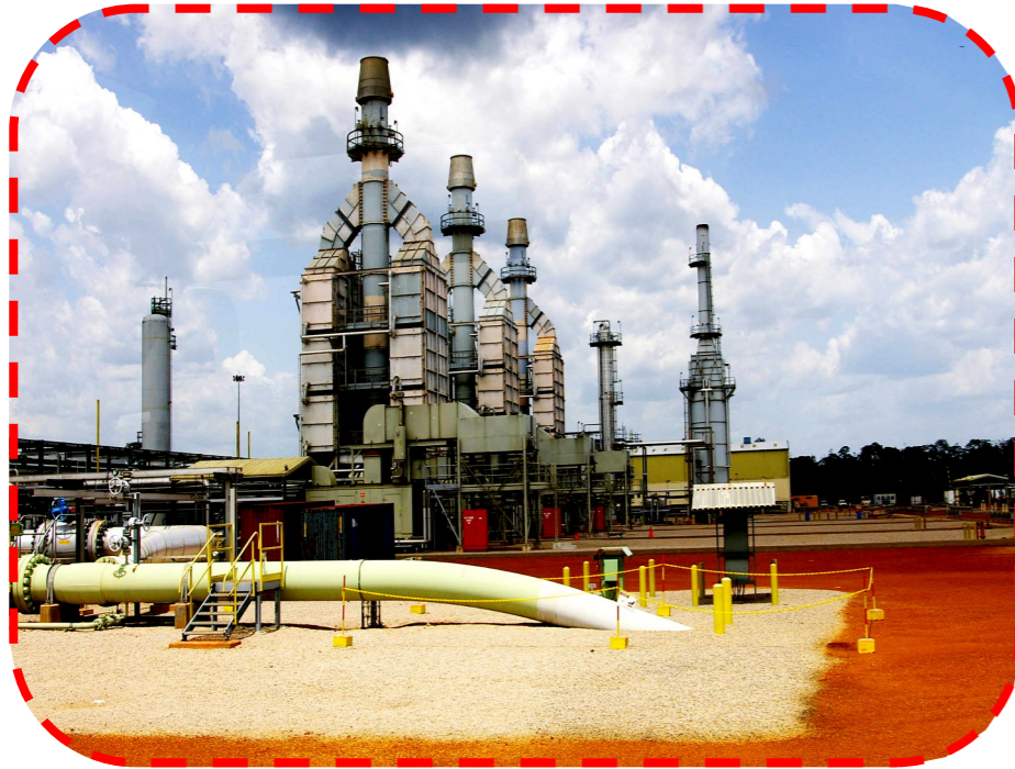
Vue de la Station de Pompage de Bélabo
