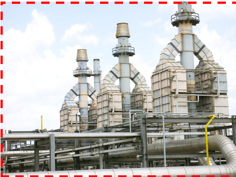
Une vue de la Station de pompage de Bélabo (Pipeline Tchad/Cameroun) exploité par COTCO
