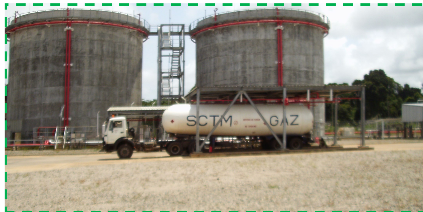
Une vue des installations du dépôt GPL de Bipaga pendant le chargement d'un camion-citerne.
