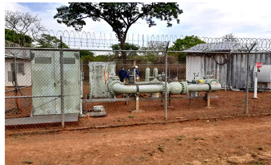
Une vanne située sur le tronçon du pipeline Tchad/Cameroun
