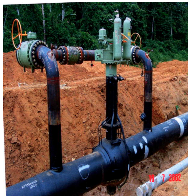
Une des vannes installées le long du pipeline.
