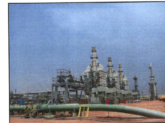
L'arrivée du pipeline dans la station de pompage, au 1 er plan. En arrière plan, les groupes de pompage (turbines et pompes)
